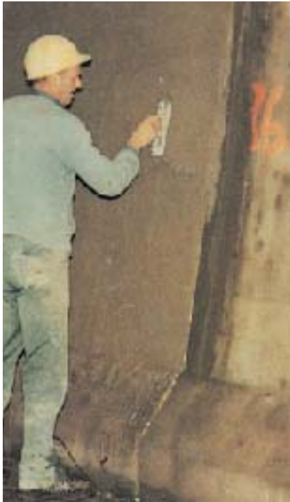
Enduit ciment adjuvanté de PLANICRETE. Chantier Tunnel autoroutier Ville Marie Montreal - Canada.
